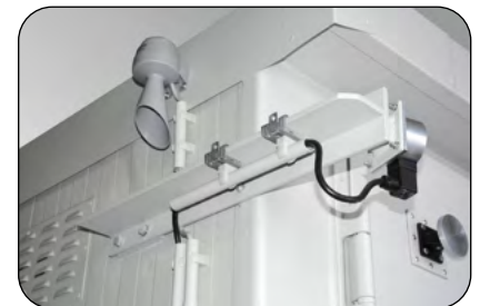
Türhalteanlage und Signalhupe für Ex-geschützte Abluftüberwachung
